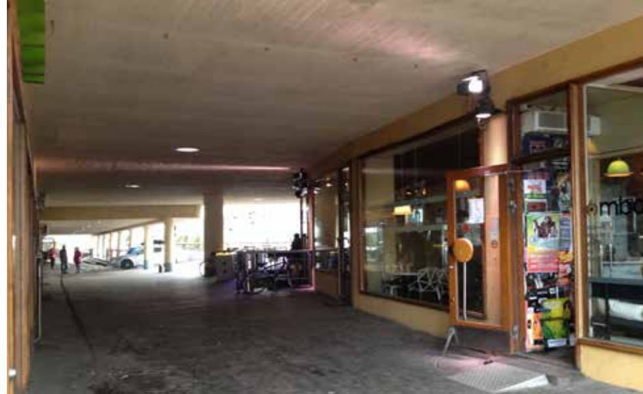
Restauroinnin jälkeen toteutetut terassit ovat muuttaneet arkadin luonnetta suljetummaksi, jota vahvistavat myös liiketilojen verhoihin tai tarrapinnoin peitetyt näyteikkunat.
