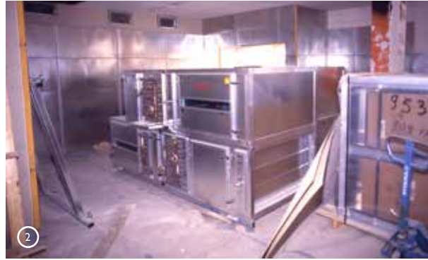
Restauroinnissa rakennettu uusi IV-konehuone, kuva vuodelta 1998.
